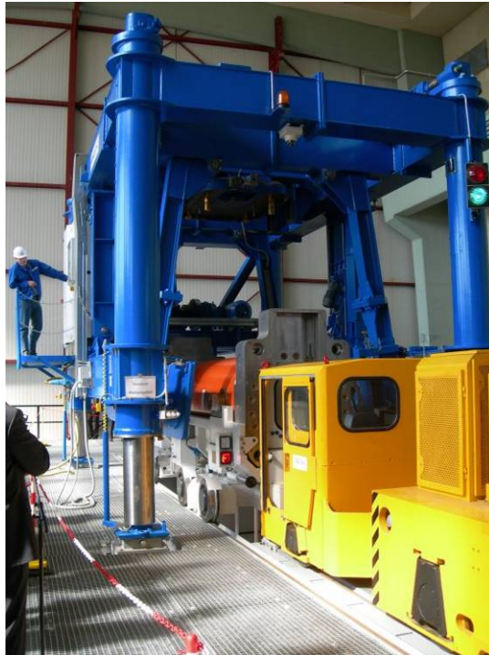
Abb. 5.10 Einlagerungsvorrichtung übernimmt den Transferbehälter
