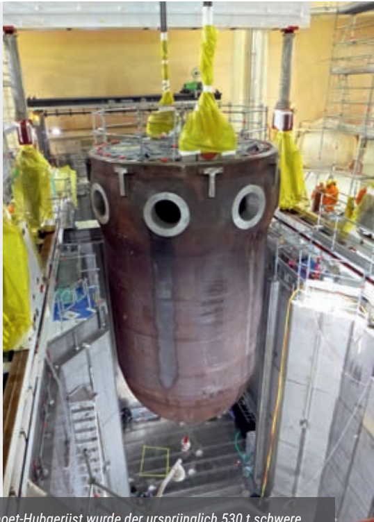
Mit dem Mammoet-Hubgerüst wurde der ursprünglich 530 t schwere RDB im KKU auf das Zerlege-Gestell für die Bodenkalotte umgesetzt.
